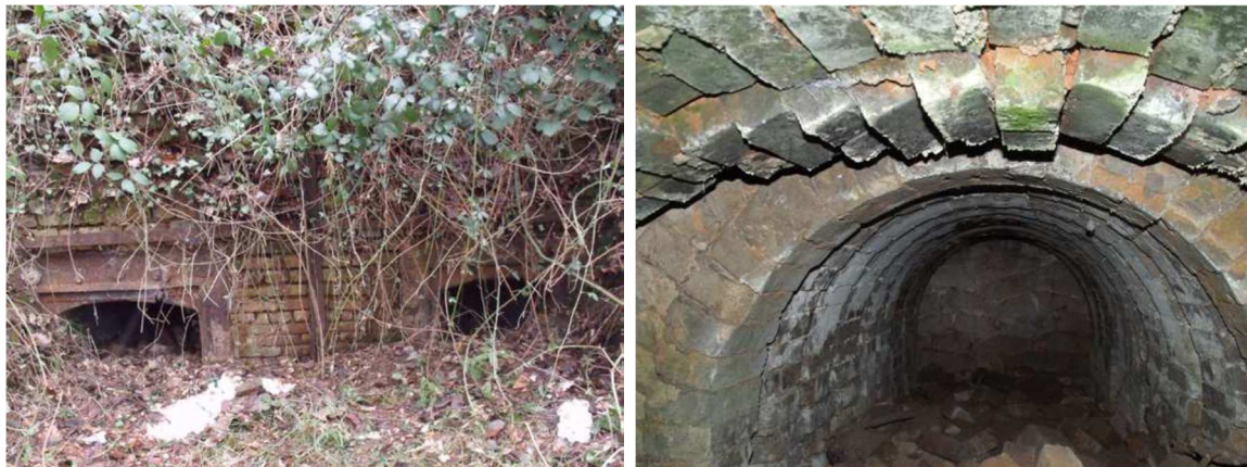
Extérieur et intérieur du four
