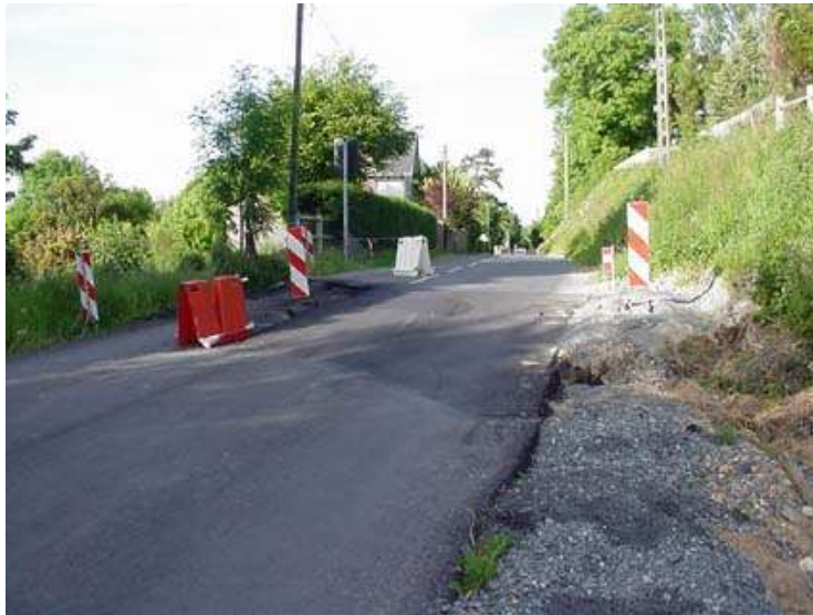
Affaissement au droit villa Mirella (détruite en 1982) au cirque des Graves (Villerville) (cliché : Maquaire, 2008)
