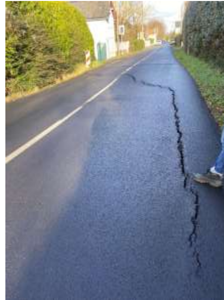
Affaissement au droit villa Trescartes au cirque des Graves (Villerville) (cliché : Maquaire, 2025)
