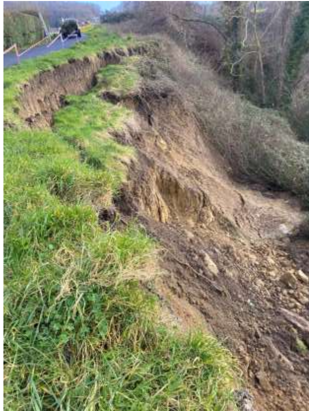
Glissement le long du chemin d'accès au cirque des Graves (Villerville) (cliché : Maquaire, 2025)
